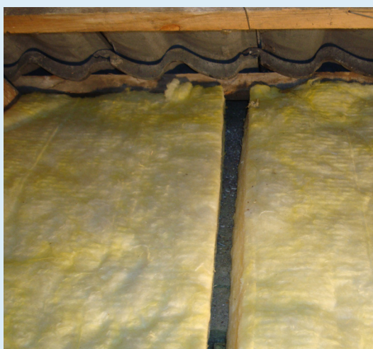
Loftisolering med sprække.
