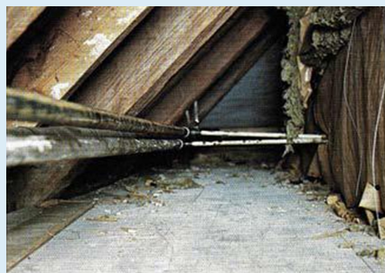
Uisolerede centralvarmerør i skunkrum.
