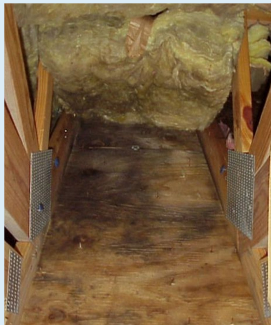
Fugtskade med angreb af skimmelsvamp.
