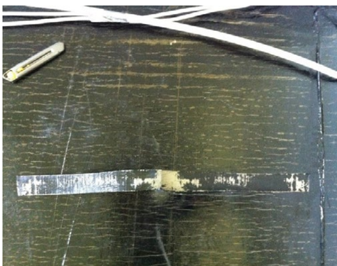
Billede 8. Trækprøve til kontrol af bitumenmembranens vedhæftning til underlaget. Bruddet skal ske i underlaget eller i bitumenmembranen.
