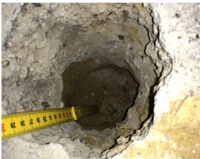
Billede 3. Øverst: Søgeåbning i et parketgulv på cementomsvøbte letklinkernødder. Nederst.: Terrændækskonstruktionen er åbnet helt ned til det kapillarbrydende lag, som er et jordfugtigt sandlag.
