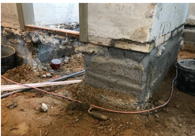
Billede 14. Søgeåbninger til at undersøge forud for projektering og udbud, om skillevæggsfundamenter skal understøbes ved udskiftning af et terrændæk (øverst). Understøbte skillevæggsfundamenter efter udgravning til ny terrændækskonstruktion (nederst).
