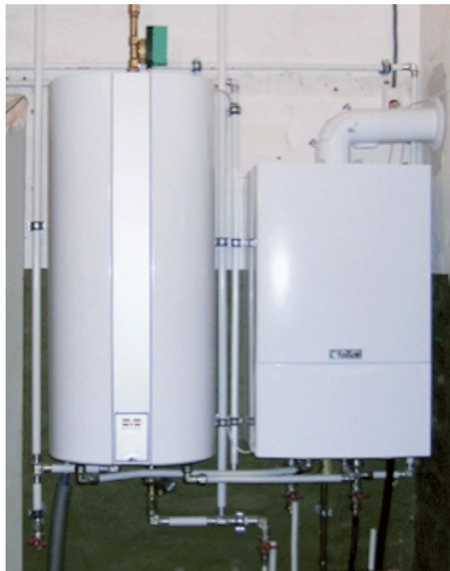
Ny varmtvandsbeholder med ny gaskedel
