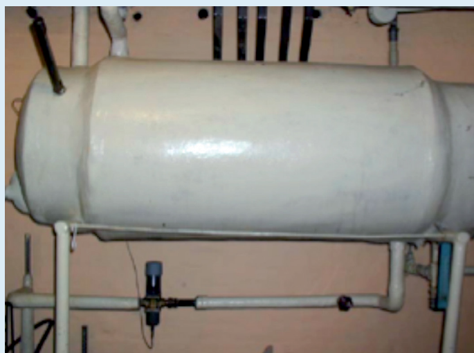
Ældre vandretliggende varmtvandsbeholder
