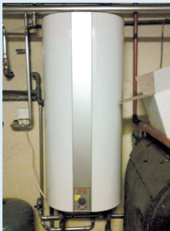
Nyere lodretstående varmtvandsbeholder
