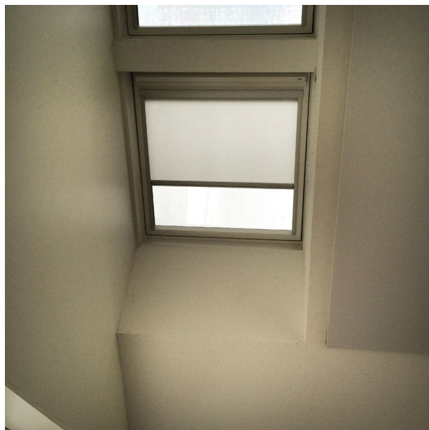
Vippevindue i tag til afkast af luft
