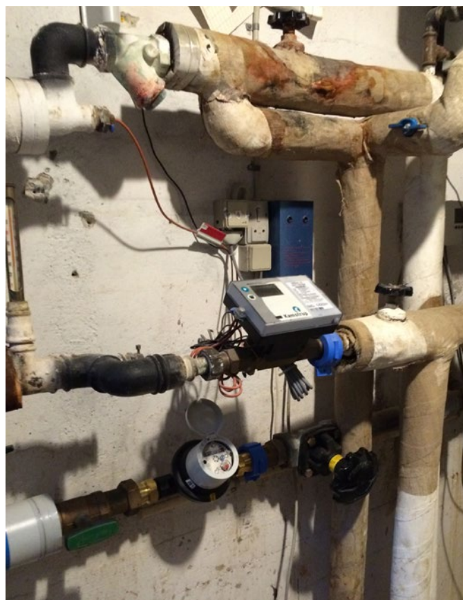
Vekslerens ydelse/effekt kan aflæses på varmemåleren, der desuden måler flow samt fremløbs- og returtemperatur.
