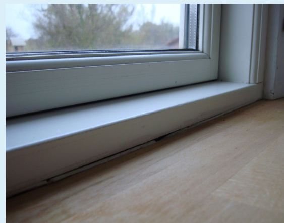
Utæt fuge under vindue.
