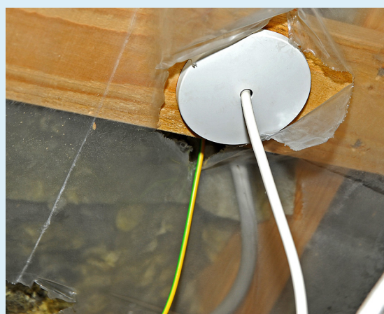
Utætheder ved lampeudtag.
