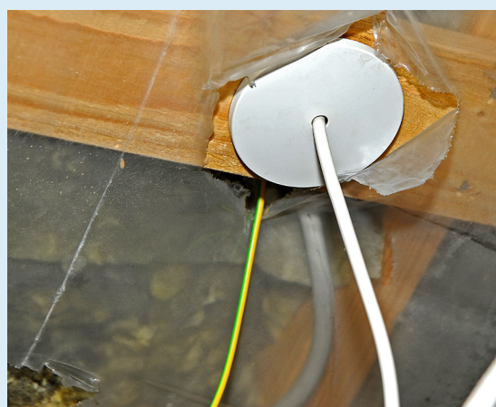
Utætheder ved lampeudtag.
