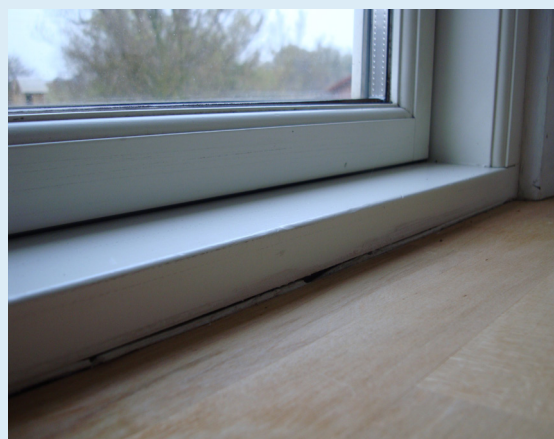
Utæt fuge under vindue.
