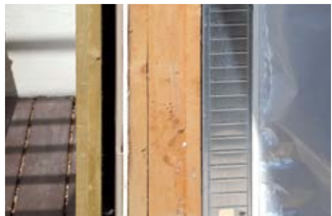
Efterisolering af let ydervæg udført før BR15. Konstruktion set fra ydersiden (venstre): Regnskærm af brædder, hulrum, vindgips, eksisterende træskelet incl. 100-125 mm isolering, ny indvendig isolering i stålskelet, dampspærre og gipsplader.
