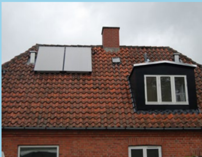
Kvist efterisoleret udefra, solvarmepaneler samt indtags- og afkasthætter til ventilationsanlæg på taget
