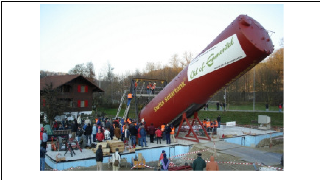
Figur 13. En 18 meter høj lagertank der rejses som led i opførelse af et nyt flerfamiliehus. Billedet er fra www.jenni.ch .
