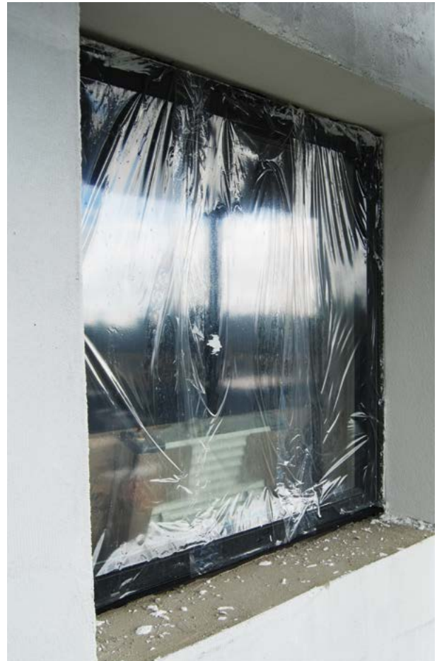
Kuldebro ved vindue er ikke brudt - ejendom fra 1953
