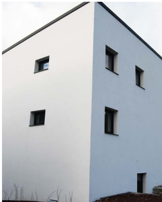
Udvendig facadeisolering med puds på ydervæg af massive letklinkerblokke på ejendom fra 1953
