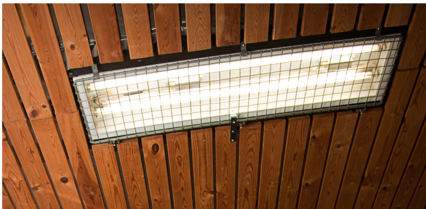
Ældre armatur med T8-lysstofør
